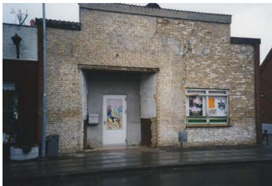
På dette billede af den "nøgne" væg ses tydeligt i murstenene, hvor stor en udvidelse af biografen der var tale om i 1942.
